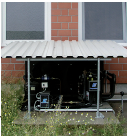
Wird das Kühlaggregat draußen montiert, spart man 2 bis 3 % an Energie ein.
