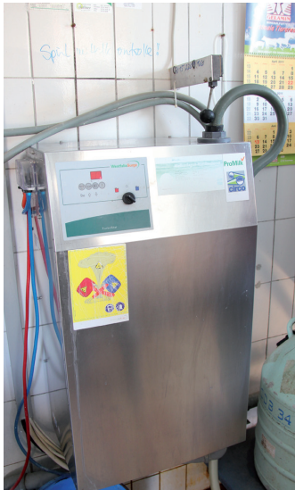
Die Rücklauftemperatur bei der Spülung könnte reduziert werden.
