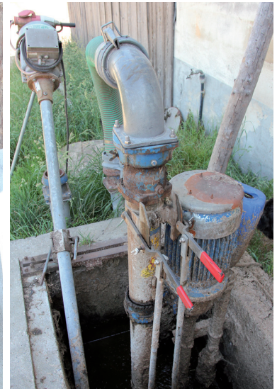
Die Laufzeit der beiden Gülle-Rührwerke könnte per Zeitschaltuhr in den Niedrigtarif gelegt werden.
