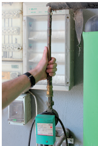
Fehlt an Leitungen die Isolierung kostet das 16 €/m.
